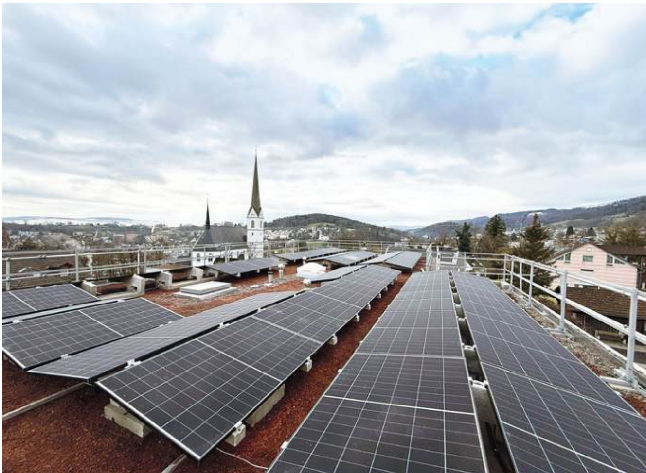
Photovoltaikanlage auf dem Dach der Liegenschaft Rellstenstrasse 15 in Adliswil
